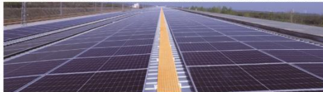
★ 沂沭铁路临沂站货场雨棚屋顶分布式光伏发电项目
