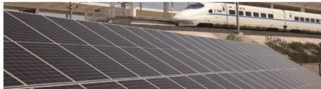
★ 青州市北站屋面分布式光伏项目
